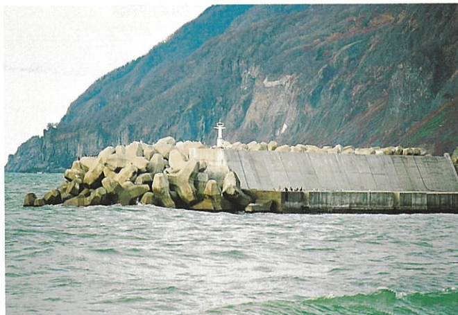
札幌土木現業所 幌漁港(20 t 型・30 t 型)
