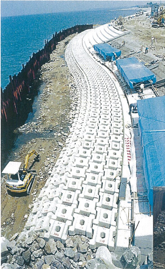
根固工 富山県魚津土木事務所 主要地方道魚津生地入善線 道路改良工事 サーフブロック1TON型
