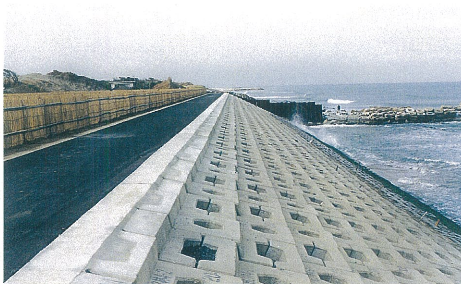
緩傾斜護岸 茨城県林業課 鹿島海岸防災林造成事業工事 サーフブロック2TON型 2割勾配にて施工
