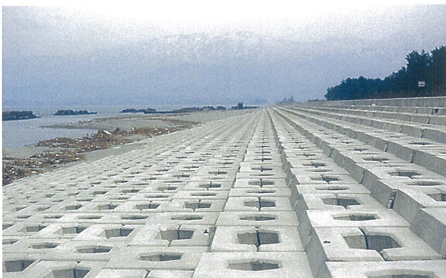
緩傾斜護岸 富山県富山土木事務所 富山海岸侵食対策工事 サーフブロック2TON型 5割勾配にて施工
