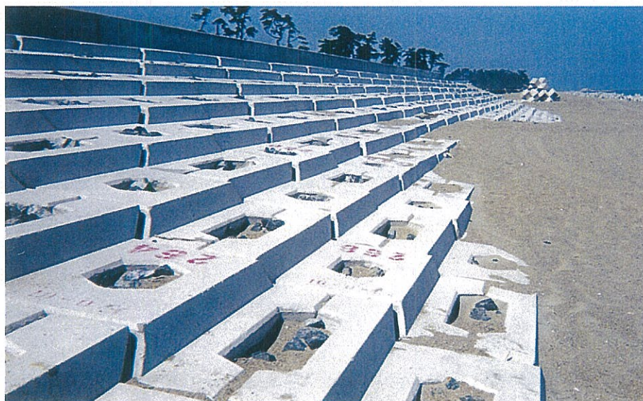
緩傾斜護岸 福島県相双建設事務所 木崎海岸局部改良工事 サーフブロック2TON型 3割勾配にて施工
