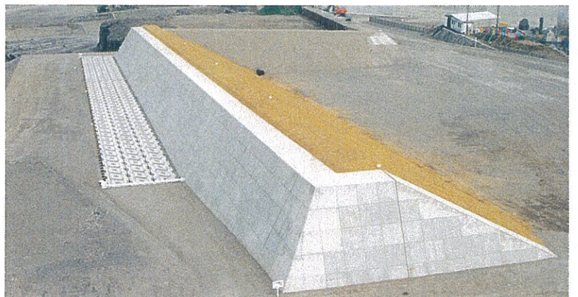
根固工 富山県入善土木事務所 黒部川支川西船合谷川地すべり対策工事 サーフブロック1TON型 基本1型配列(2段積み施工)
