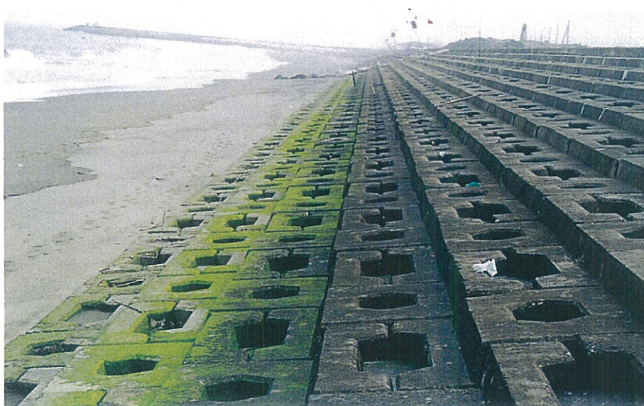
緩傾斜護岸 千葉県長生土木事務所 一宮海岸災害復旧工事 サーフブロック2TON型 3割勾配にて施工
